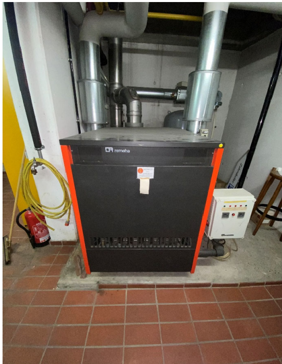
Bestehende Gasheizung Baujahr 1990
